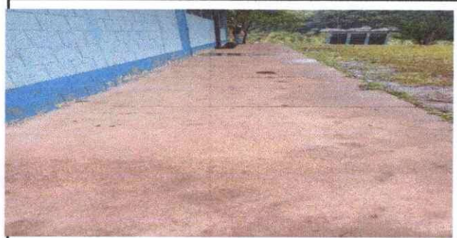
Foto 2: el corredor de la esta en mal estado
